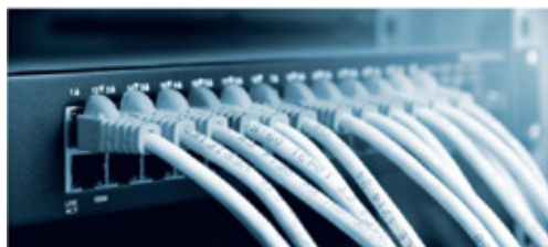
FIGURA 16 – PATCH PANEL COM UTILIZAÇÃO DE CABOS DE PAR TRANÇADO
